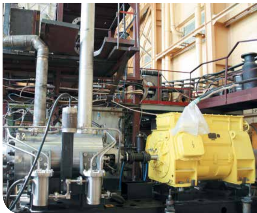
ЦКБМ. Аварийный насос АЦН-1721 на испытательном стенде
